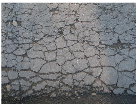
شکل ۱-۶ تخریب آسفالت ناشی از ترک خوردگی
