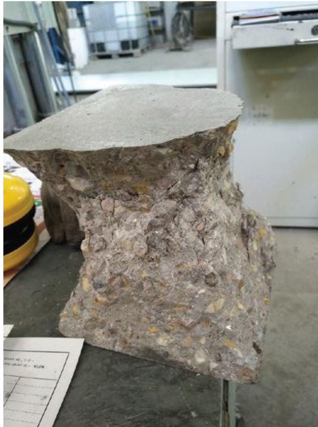
شکل ۴-۶ شکل صحیحی از شکست بتن
