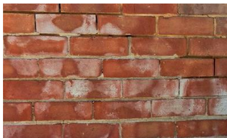
شکل ۱-۴ تبلور نمک در آجر
