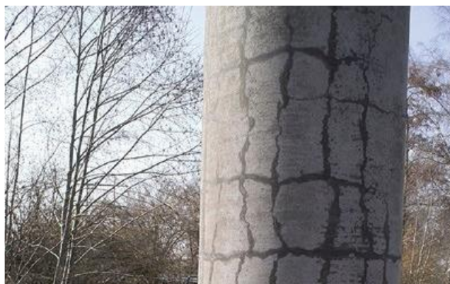
شکل ۶-۱۲ ترک خوردن در تیرک بتنی یک پل به دلیل واکنش قلیایی-سیلیسی
